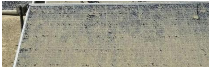
Fig.2. A dusted PV module
